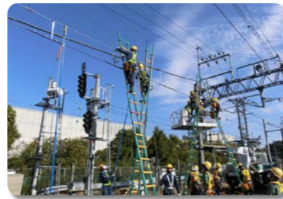
電車線技術研修
