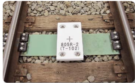
連続速度照査用のATS地上子
