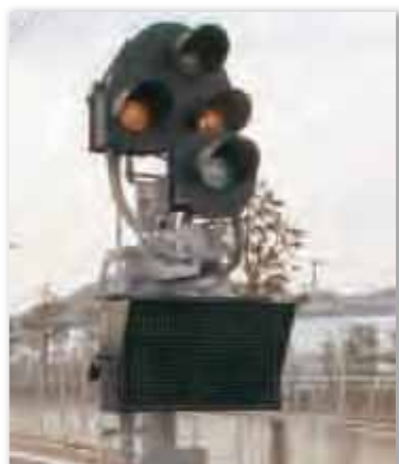
入換信号機のLED化
