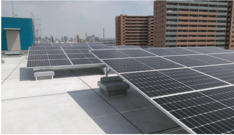
太陽光発電設備（駅事務所屋上）
